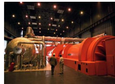
6. Sala de turbines de la central nuclear d'Almaraz.
