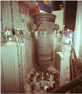
52. Vas del reactor de la central nuclear de Vandellós II.
