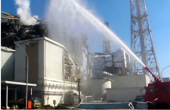
31. Equip de bombers llançant aigua per sobre del reactor 3.
