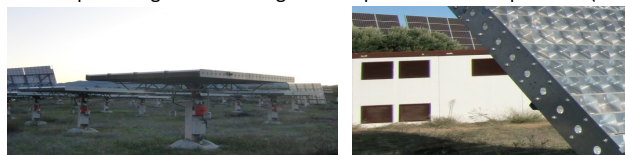
Vista panell en posició de defensa Vista caseta estació transformadora
